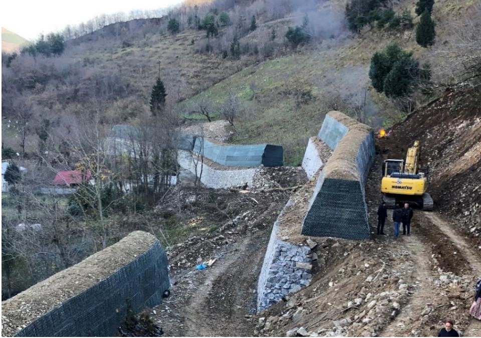
Şekil 3. KTTD içerisinde geçiş koridoru yerine geleneksel yöntem bindirme uygulaması.
